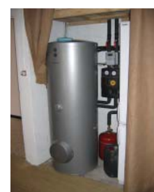
Ballon de stockage eau chaude
