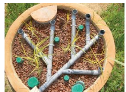
Une araignée de distribution, raccordée à l'arrivée de l'effluent, est posée en surface.
