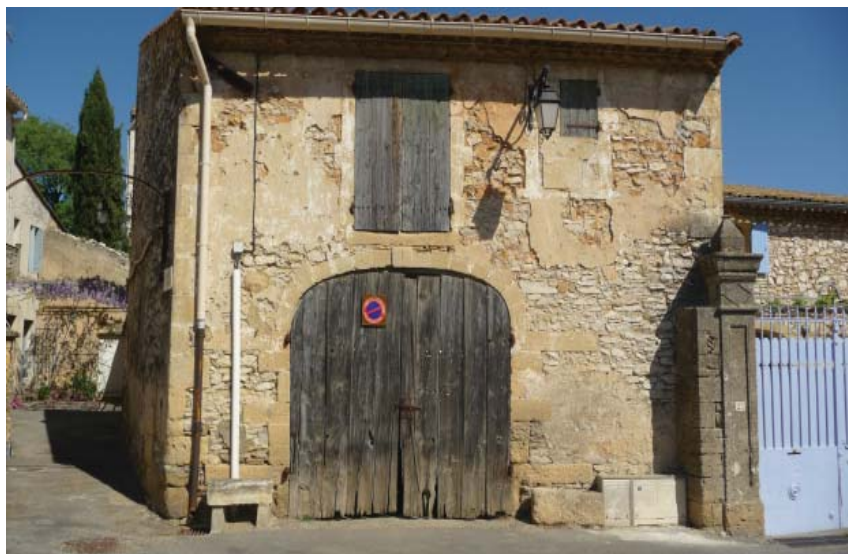
... annexes agricoles, plus rudimentaires, cohabitent dans les centres anciens et présentent des caractéristiques propres (ici à Cabrières)
