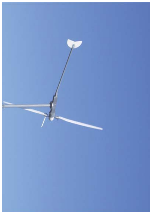
Aérogénérateur à axe horizontal
