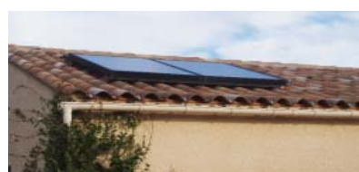
Capteurs en surimposition de toiture (4 m 2 environ de surface de capteurs solaires thermiques pour 200 à 300l d'eau chaude)
