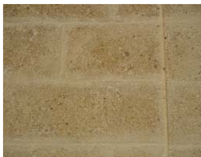
Seules les façades en pierres nobles taillées étaient conçues pour rester apparentes (ci-dessus, moellons appareillés)
