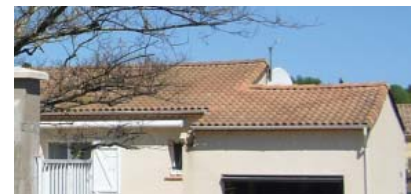
Tuile mécanique dite "romane" à éviter
