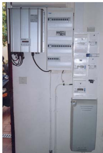
Onduleur et compteur de production
