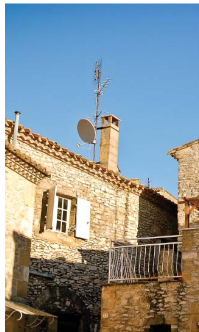
Cheminée à effet de "quille" en raison d'un conduit trop long : à éviter en positionnant ce conduit le plus proche possible du faîtage
