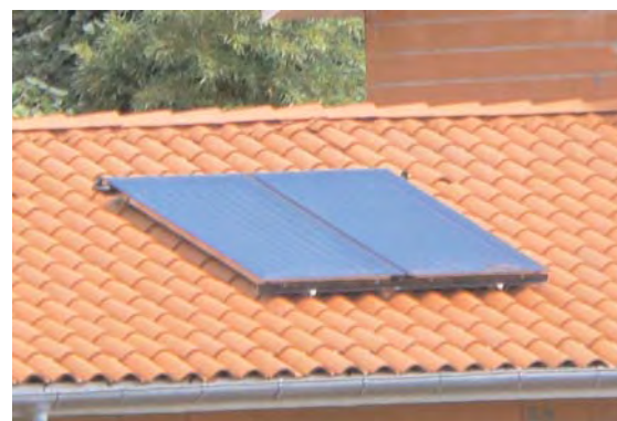
Installation de panneaux solaires sans réflexion liée à l'intégration, bien que la bâtisse soit en chantier
