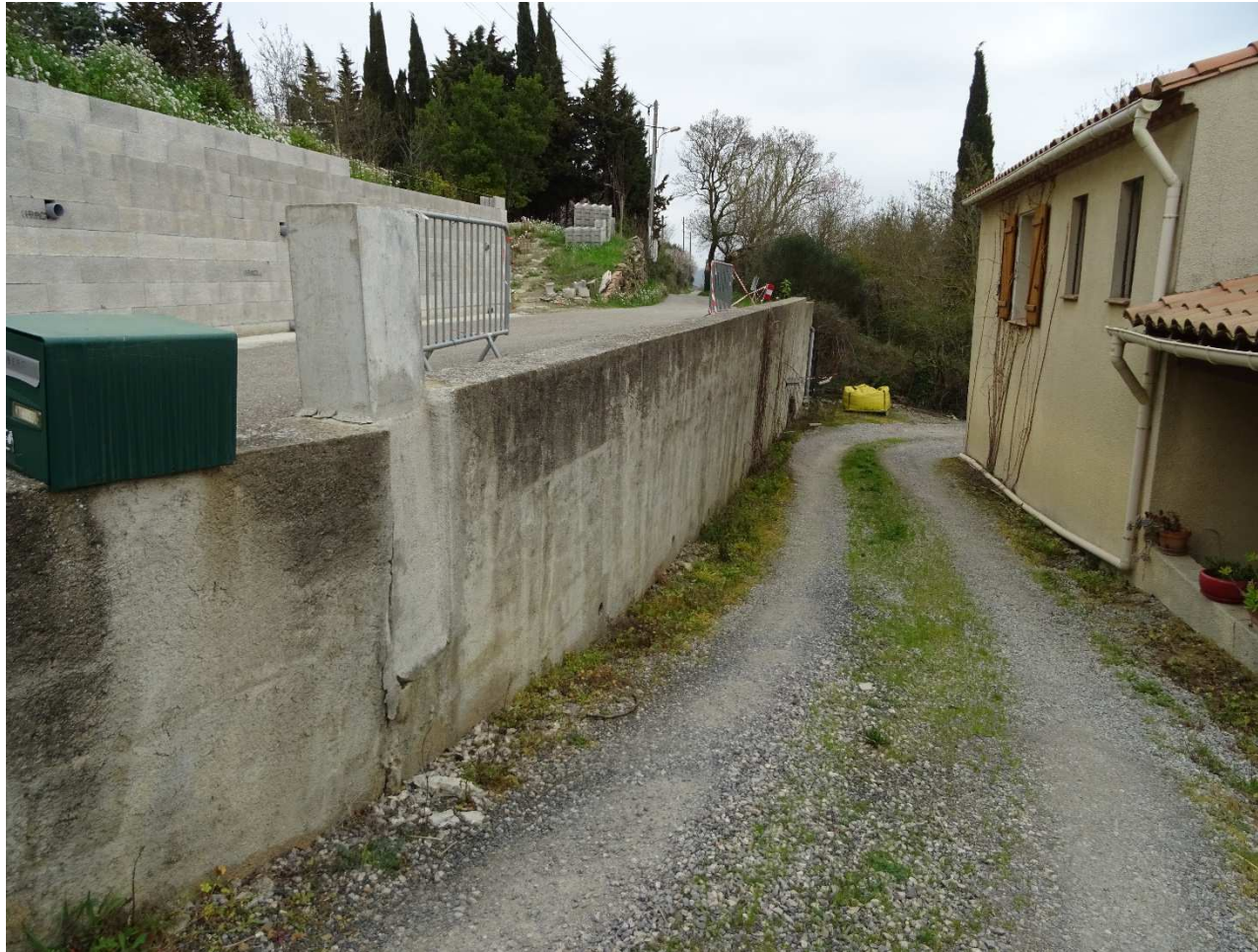
Mur avec un basculement de 25 cm vers l'aval
