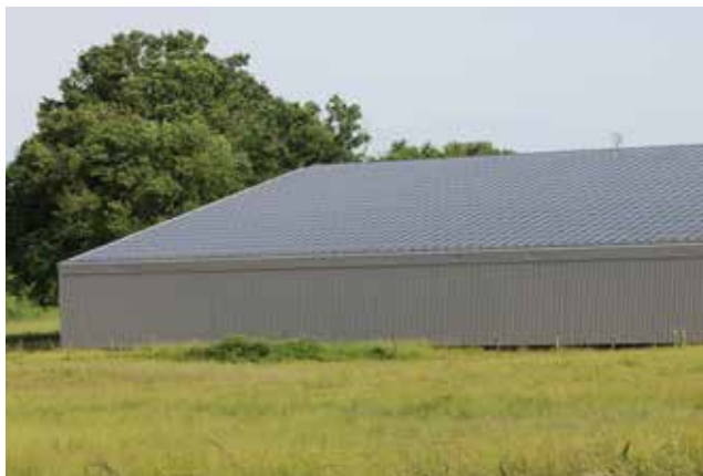
Unité de teintes et continuité entre les panneaux photovoltaïques et le bardage métallique gris
