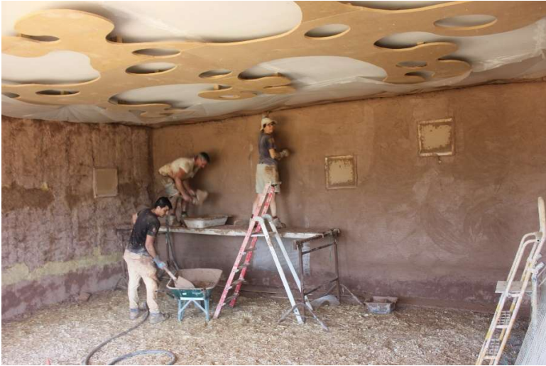
Collège Caminarem, Méjeannes-les-Alès, enduits terre sur bottes de paille, 2019, Fabrice Perrin, arch.,
