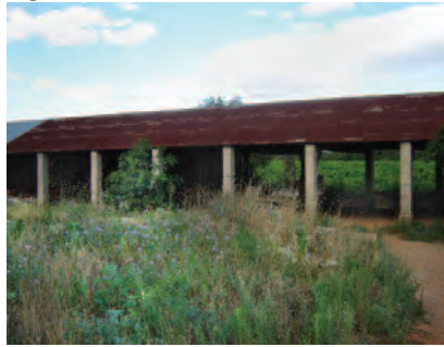
Anciens logements ouvriers en attente de réhabilitation.
