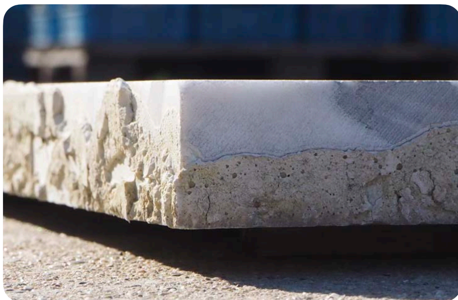
Présence de résidus de mortier
