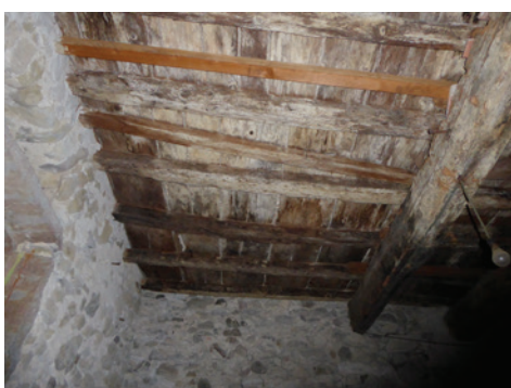
Etat des planchers intérieurs hauts du RdC
