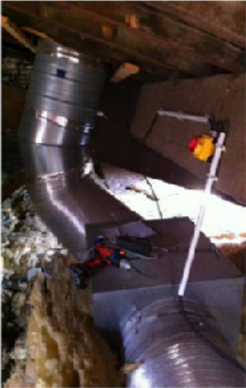
Figure 5 : Caisson d'extraction aile Ouest
