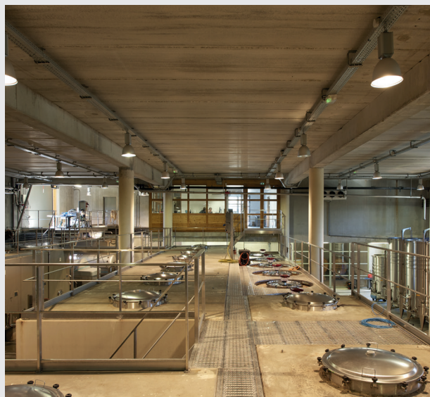
Cuves béton et inox accueillent les vendanges par le haut.
